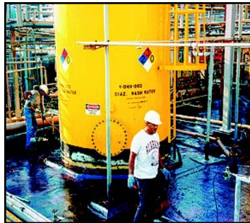
AREAS DE CONTENCIÓN DE QUÍMICOS
