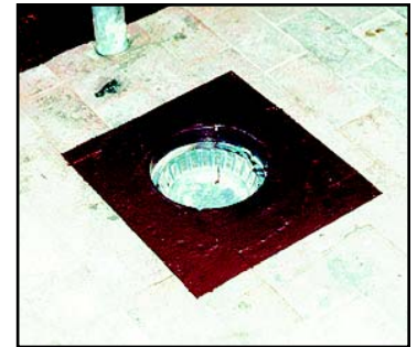
DESAGÜES Y CANALETAS
