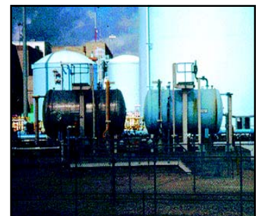
TANQUES DE ALMACENAMIENTO DE QUÍMICOS
