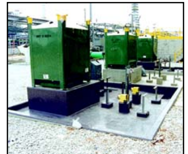
AREAS DE CONTENCIÓN DE QUÍMICOS
