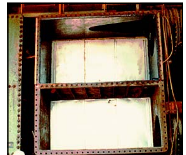
TANQUES DE CONDENSADORES
