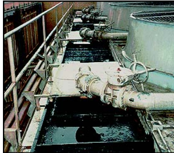
TORRES DE ENFRIAMIENTO
