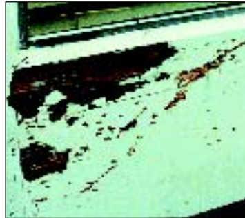
REPARACIÓN DE MADERA PODRIDA
